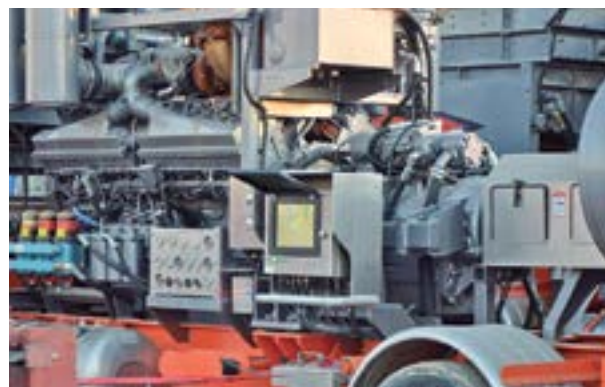
Figura 3. Lime Instruments utilizó la misma plataforma para realizar un control de procesos y monitorización de condiciones avanzado en su equipo de campo.
