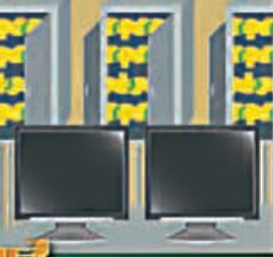
SALA DE CONTROL
